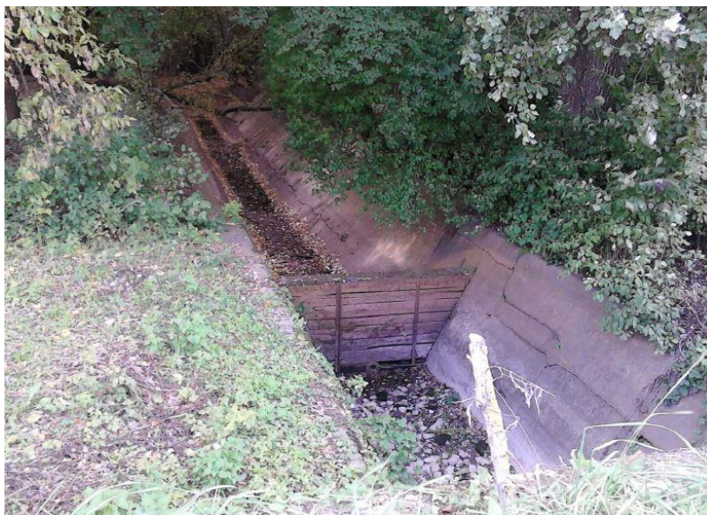
Slika 2.6 Izlazni cjevovod crpne stanice- početak odvodnog kanala crpne stanice (Izvor: Elaborat revitalizacije)
