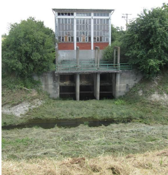
Slika 2-7 Postojeća crpna stanica Krnjak
