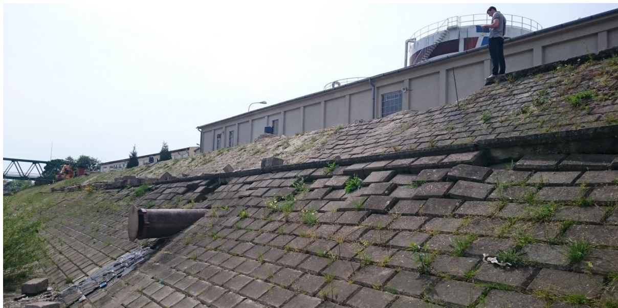
Slika 3.9: Karakteristično oštećenje obaloutvrde u postojećem stanju na poddionici između dva mosta
